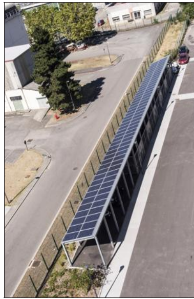
Une ombrière photovoltaïque. Photo Denis MOREL/G2Elab/CNRS Photothèque
