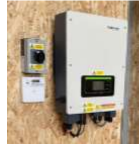
Onduleur PV DC-AC
