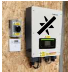
Onduleur PV DC-AC
