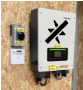
Onduleur PV DC-AC
