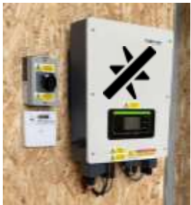
Onduleur PV DC-AC
